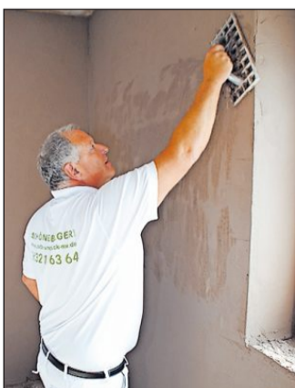
Der Meister legt natürlich auch selbst Hand an: Joachim Schöneberger bei der Arbeit in einem Rohbau. FOTO: FFG
